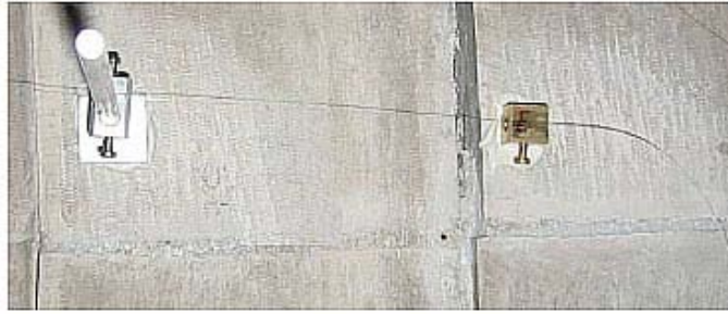
SENSORES DESPUÉS DE LA INSTALACIÓN
